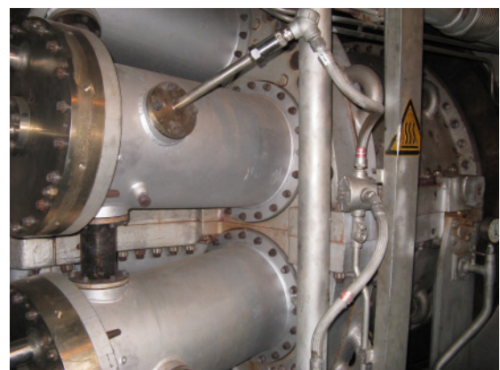
Bild 3: Erdgasbrenner und Brennkammer
