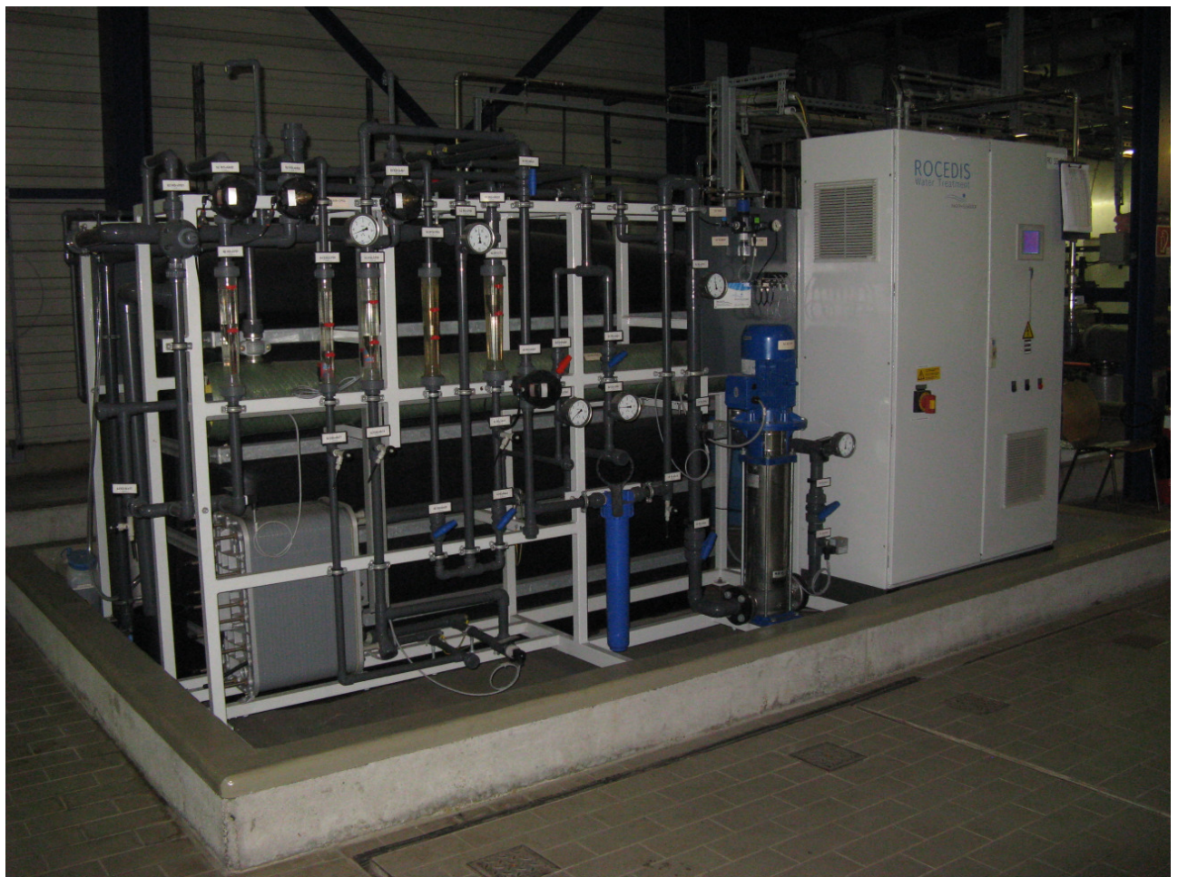
Bild 1: Vollentsalzungsanlage mit Auffangwanne
