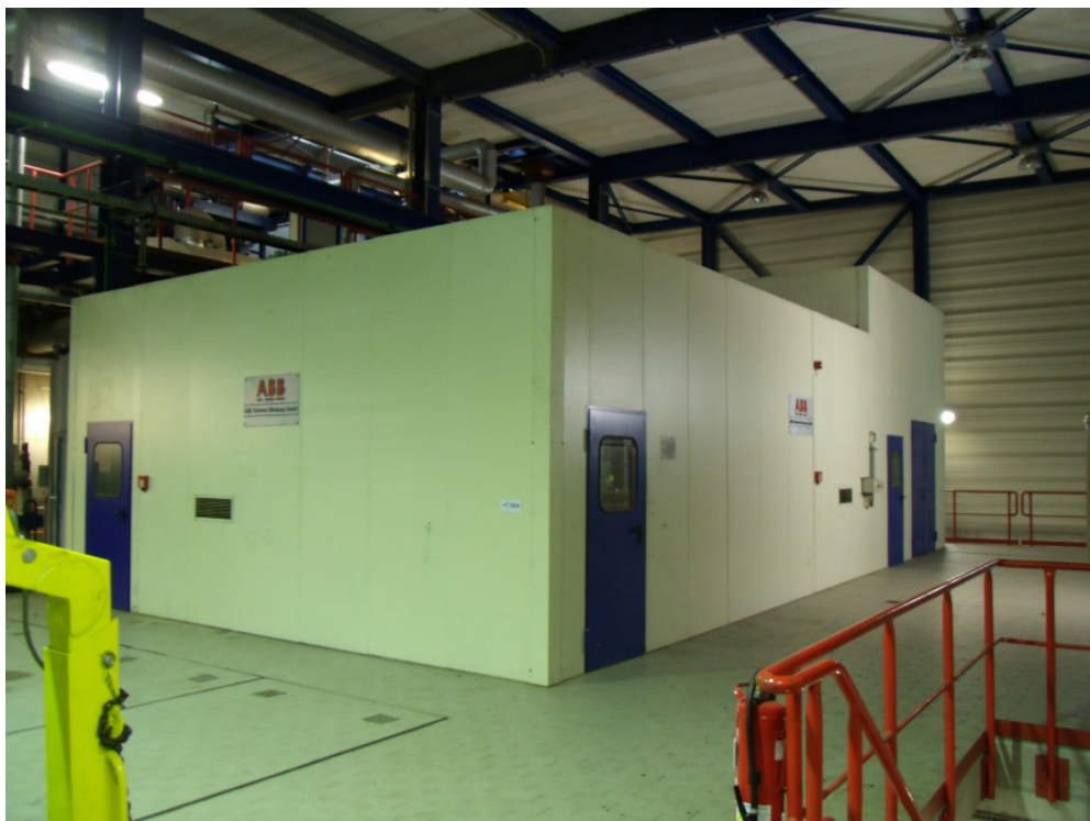
Bild 1: Einhausung Generator, Getriebe und Turbine
