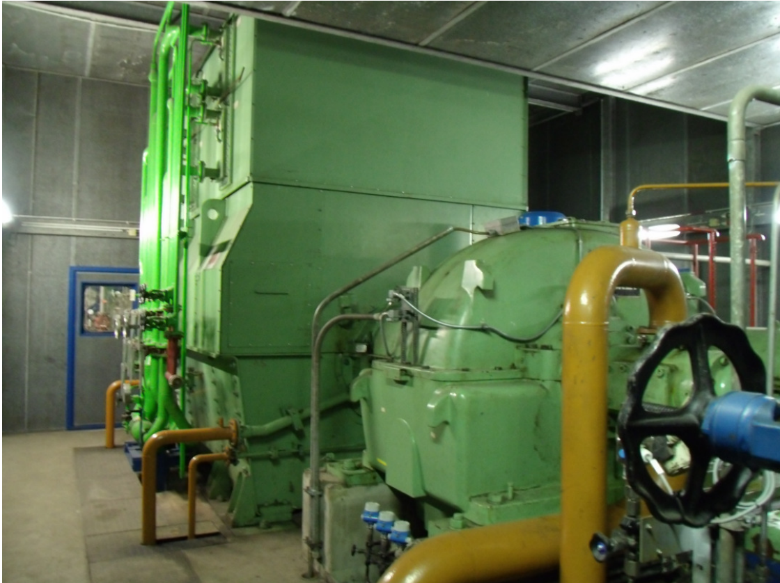
Bild 3: Generator und Getriebe
