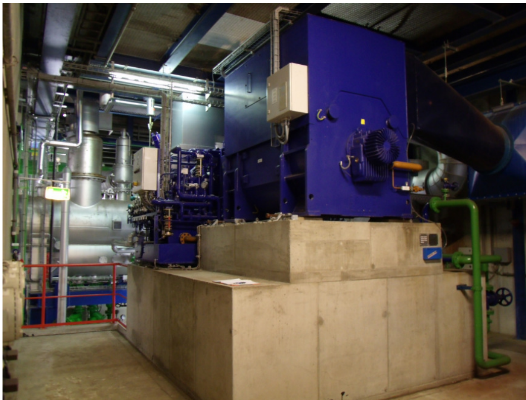
Bild 3: Fundament mit Generator, Getriebe, Ölversorgung und Dampfturbine
